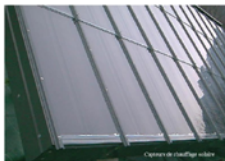
Capteurs de chauffage solaire
